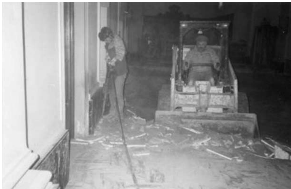
Disfacimento del pavimento in marmo della chiesa. Anno 2001.
